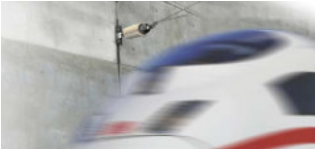
Oberleitung im Tunnel
